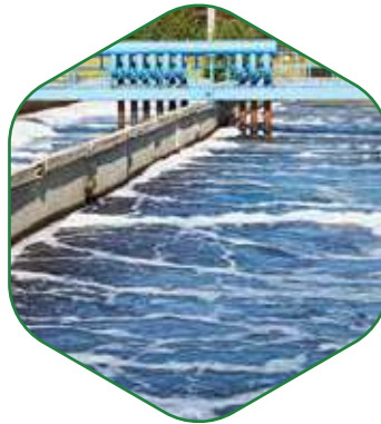
Effluent Treatment Plant (ETP)
